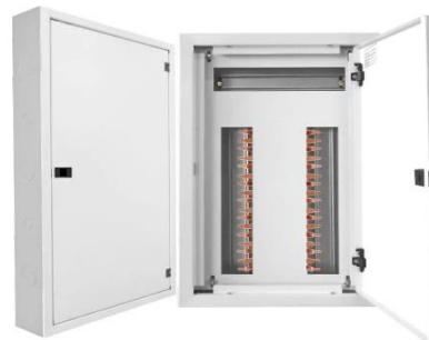
IMAGEM 12 – Quadro de distribuição Metálico
